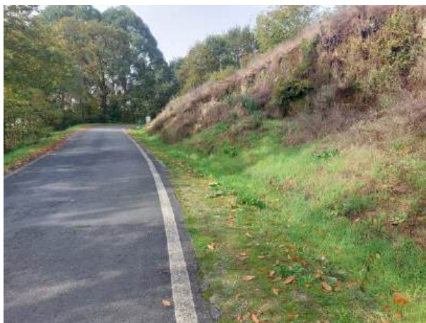
Fotografía 43: Estado actual - Treito 645_T2
