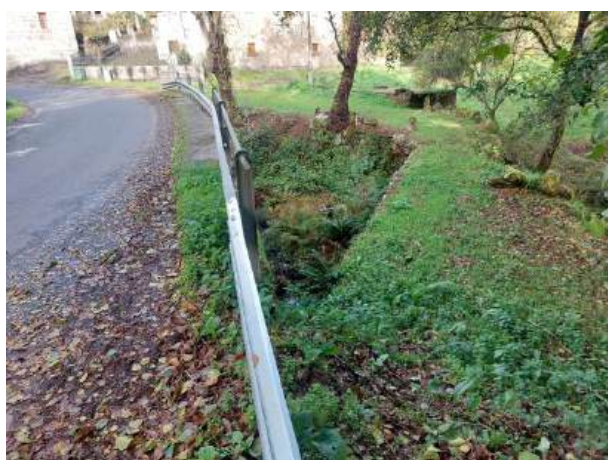
Fotografía 42: Estado actual - Treito 645_T2
