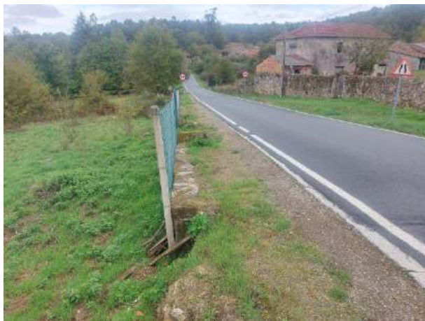
Fotografía 137: Estado actual - Treito 698_T1
