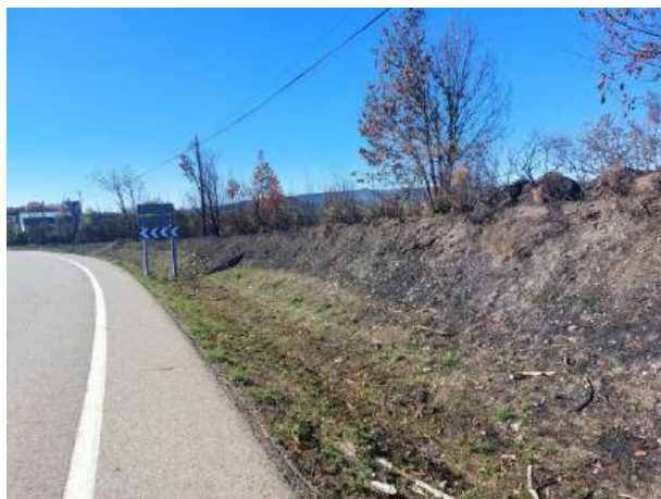
Fotografía 64: Estado actual - Treito 660_T1
