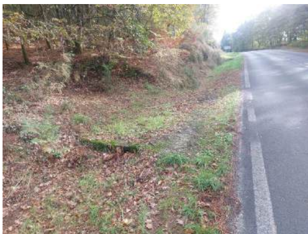
Fotografía 140: Estado actual - Treito 698_T2
