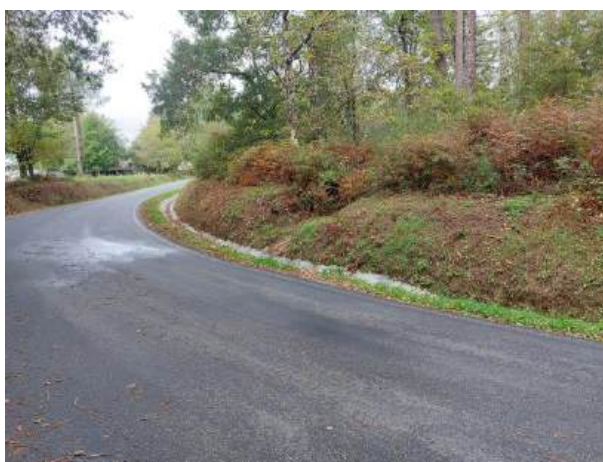
Fotografía 38: Estado actual - Treito 645_T1
