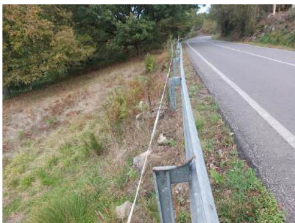
Fotografía 116: Estado actual - Treito 678_T2
