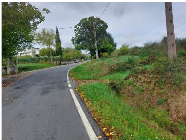
Fotografía 39: Estado actual - Treito 645_T1
