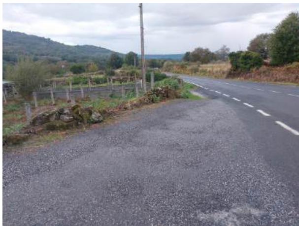
Fotografía 103: Estado actual - Treito 677_T3
