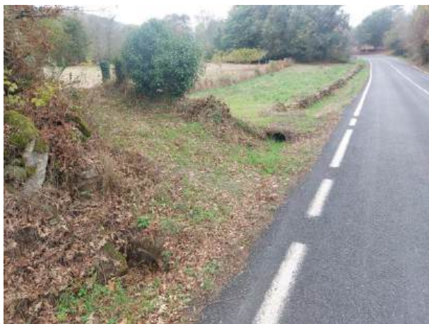
Fotografía 101: Estado actual - Treito 677_T2
