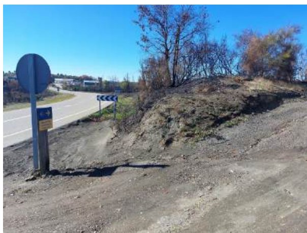
Fotografía 63: Estado actual - Treito 660_T1
