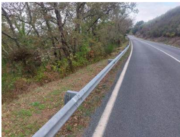
Fotografía 98: Estado actual - Treito 677_T1
