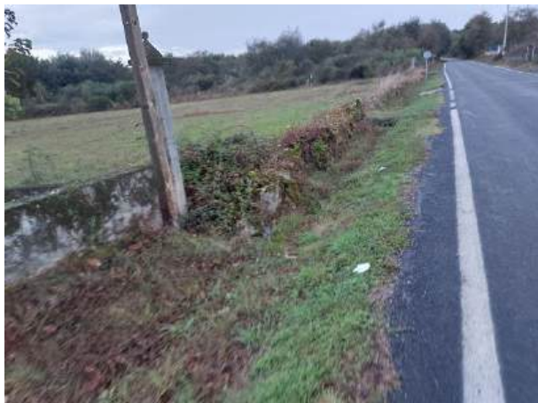
Fotografía 107: Estado actual - Treito 677_T4
