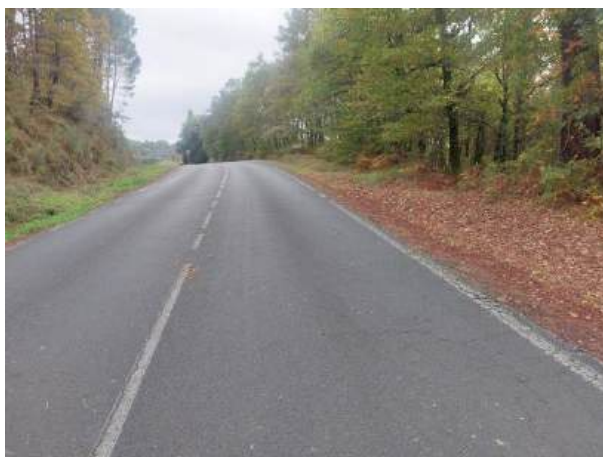
Fotografía 139: Estado actual - Treito 698_T2
