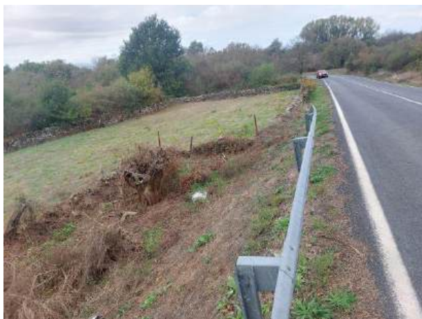
Fotografía 100: Estado actual - Treito 677_T2
