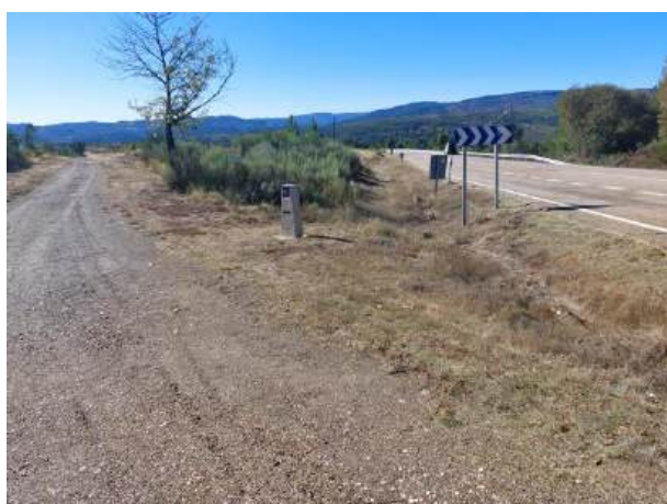
Fotografía 69: Estado actual - Treito 660_T2
