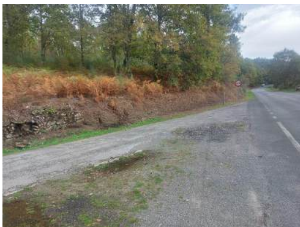
Fotografía 142: Estado actual - Treito 698_T2
